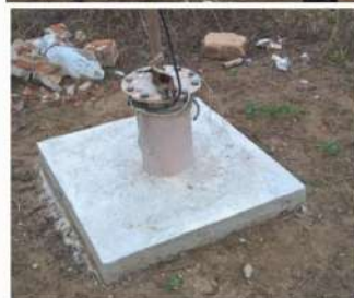
Figura 10 – Poço tubular no sítio Lagoinha.
