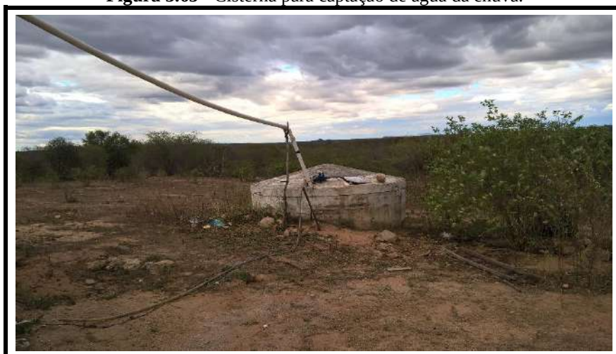
Figura 3.65 - Cisterna para captação de água da chuva.
