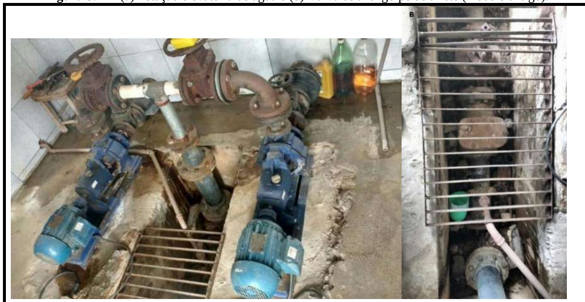
Figura 3.12 - (a) Estação elevatória de água e (b) Válvulas anti-golpe de aríete (modelo antigo).
