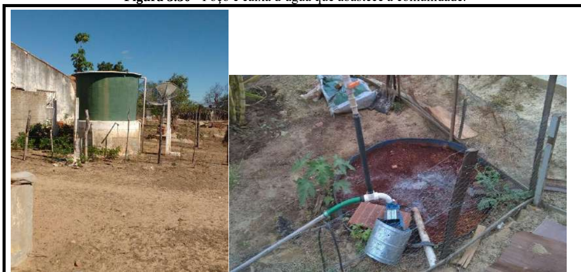
Figura 3.30 - Poço e caixa d'água que abastece a comunidade.
