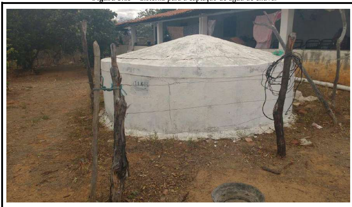
Figura 3.19 - Cisterna para a captação de água de chuva.
