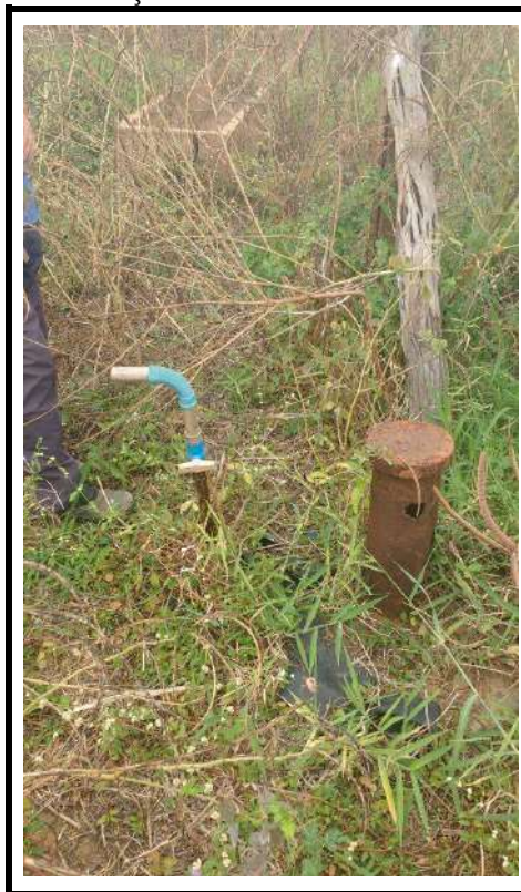
Figura 3.18 - Poço tubular da comunidade Encampinado.
