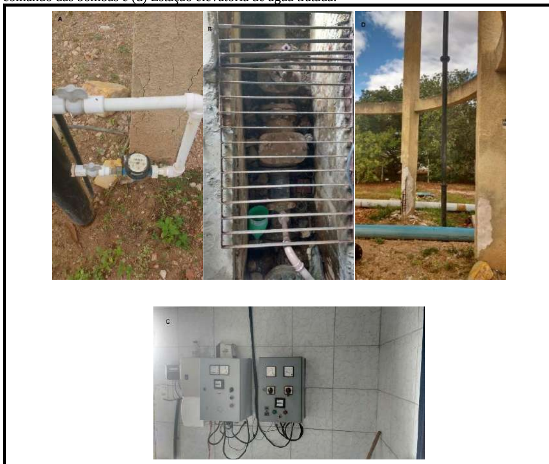
Figura 3.15 - (a) Medidor de vazão TAP, (b) Válvulas anti-golpe (modelo antigo), (c) Quadro de comando das bombas e (d) Estação elevatória de água tratada.
