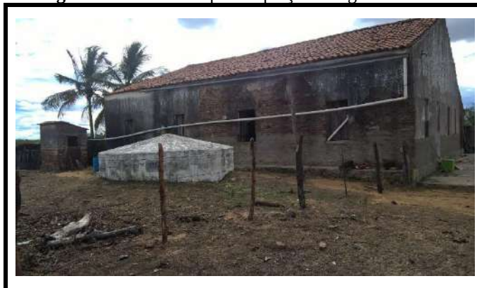
Figura 3.49- Cisterna para captação de água de chuva.
