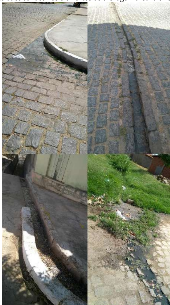
Figura 3.122 – Resíduos sólidos nos elementos de drenagem urbana existente no município.
