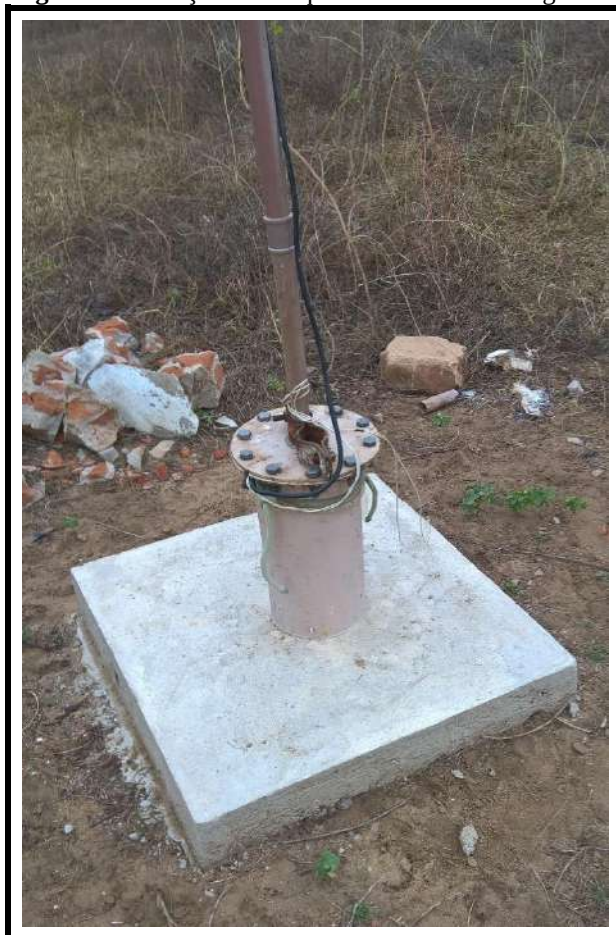
Figura 3.20- Poço tubular que abastece o sítio Lagoinha.
