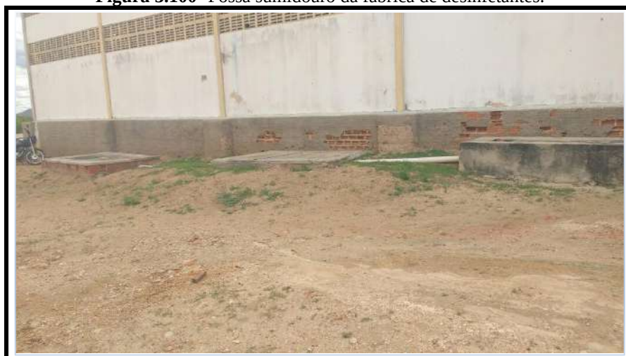
Figura 3.100- Fossa sumidouro da fábrica de desinfetantes.
