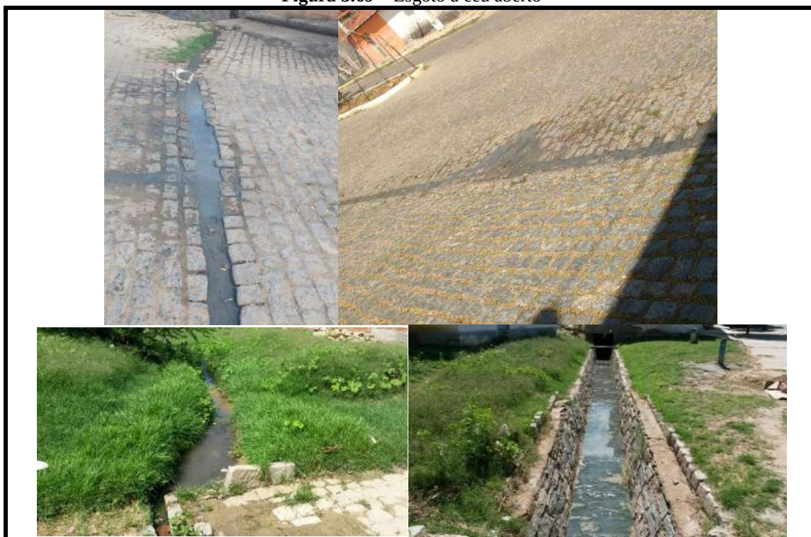
Figura 3.69 – Esgoto a céu aberto
