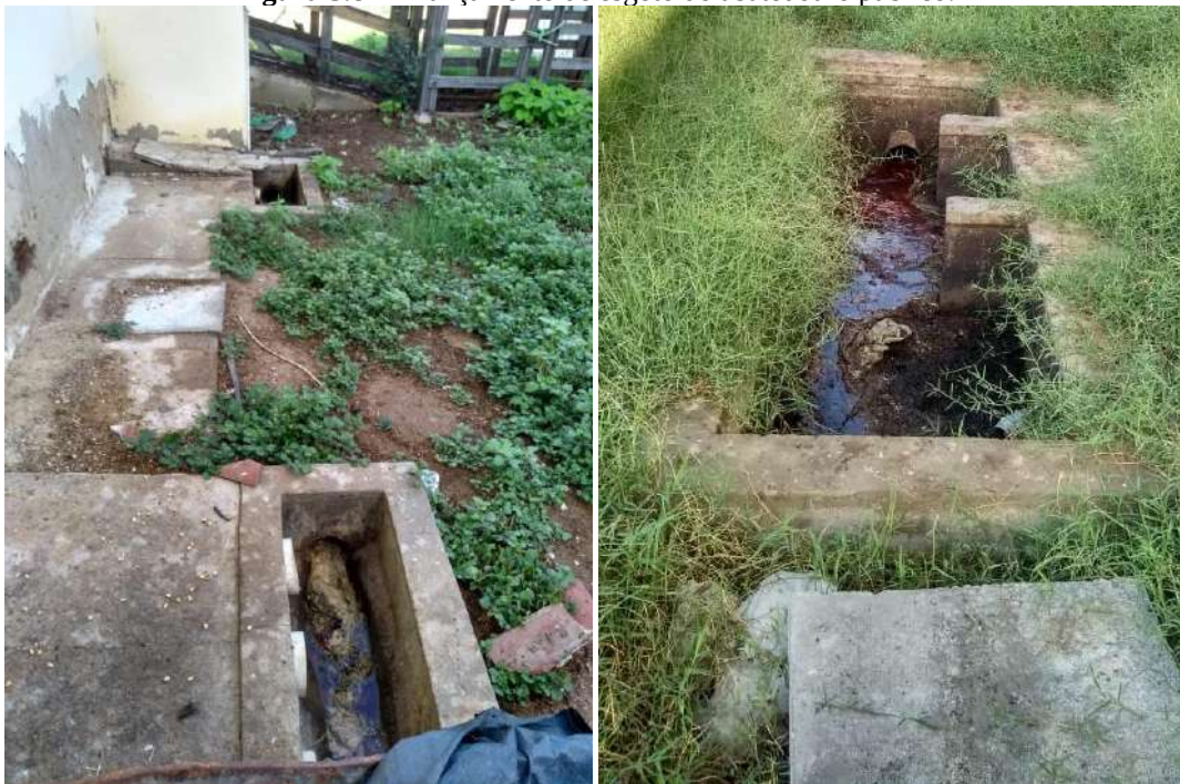
Figura 3.81 – Lançamento de esgoto do abatedouro público.
