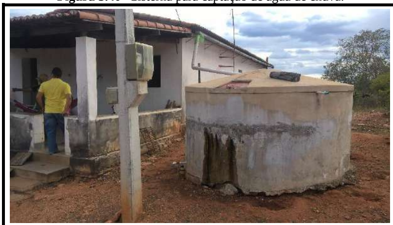
Figura 3.40- Cisterna para captação de água de chuva.
