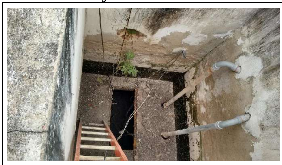
Figura 3.73 - Caixa de areia.
